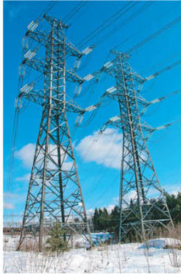
Figura 2.28. La distribución de electricidad en el mundo moderno es inconcebible sin el cableado, hecho a base de cables de cobre
